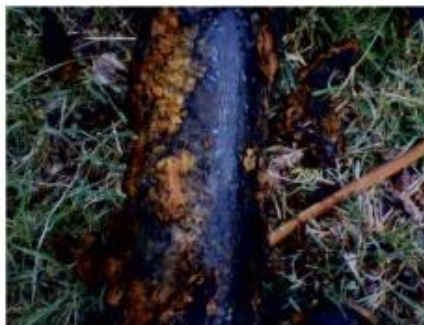
7. kép korrodált cső
