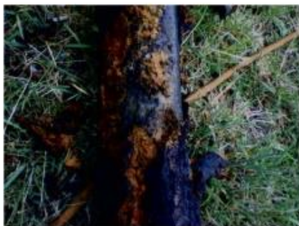
6. kép korrodált cső
